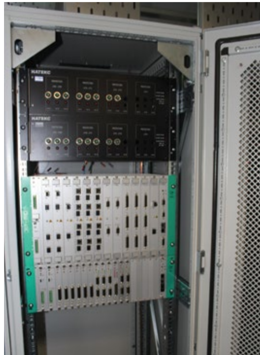
Оборудование систем передачи на центральном узле связи
